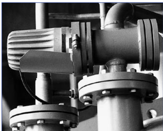
Osvětlení CHEMLUX®, typ L 20 deH M sp, 20 W, 24 V, Ex de IIC T5, Ex tD A21 IP 65 T95°C, Ex II 2 G+D, upevněno s opálovým sklem „M“ na potrubním průhledítku.
